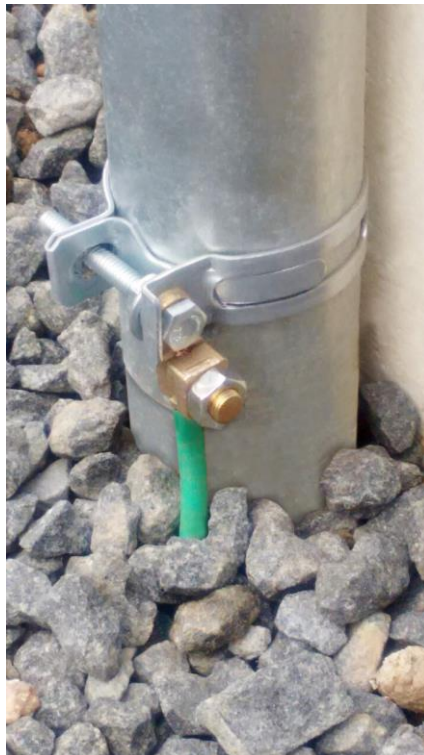
Foto ilustrativa 02 dos anexos G, H e Q – Detalhe da abraçadeira de com terminal para aterramento
